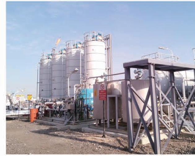
▼ 科威特KOC含油污泥处理站 Kuwait KOC Oily Sludge Treatment Station
