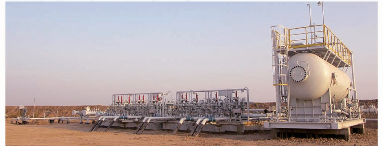
▼ 伊拉克哈法亚测试分离器和多通阀工程 Iraq Halfaya Test Separator and Multi Way Valve Project
